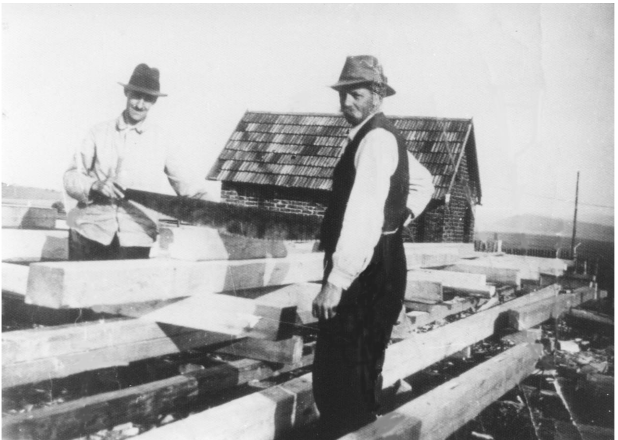
Hallenbau 1936, durch die Schützenbrüder Anton Kraft und Josef Ester (Schmies Mester), im Hintergrund das alte Toilettenhäuschen
